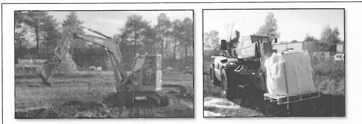
Figure 9 : engins mobilisés pour la réalisation des travaux (mini-pelle (à gauche sur la photo), chariot à fourche (à droite sur la photo))
